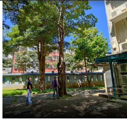
博愛樓後方高壓磚隆起
