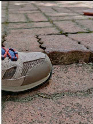
集賢樓前方高壓磚隆起
