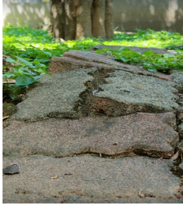
博愛樓後方高壓磚隆起
